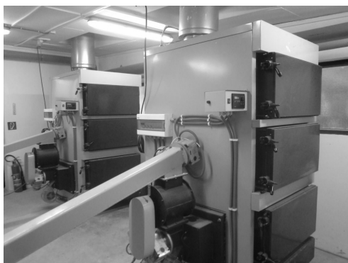
Kotłownia 2x350kW w szkole gastronomicznej
